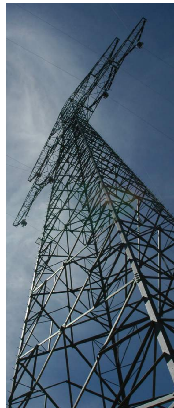
Konstrukcja kratowa słupa linii NN
